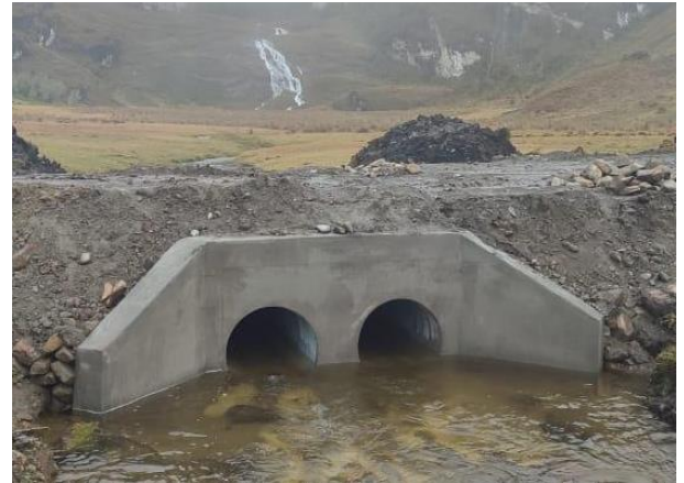
Figura 15: Alcantarilla en funcionamiento en escala real
