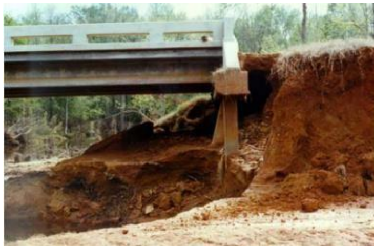
Figura 1: Erosión de la margen Fuente: Falero y Talero (2007)
