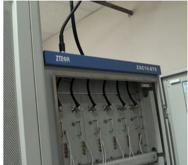
Conexión de la BTS hacia las antenas de Tx y Rx
