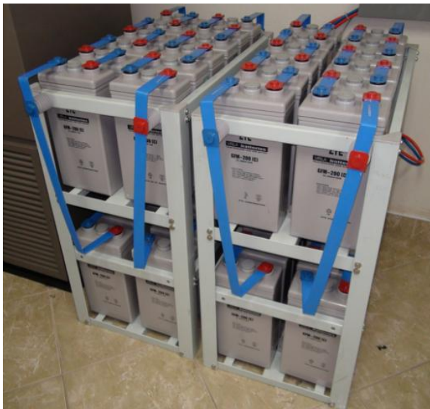
Banco de baterías: Proporciona 6 horas de energía en caso de corte de energía.
